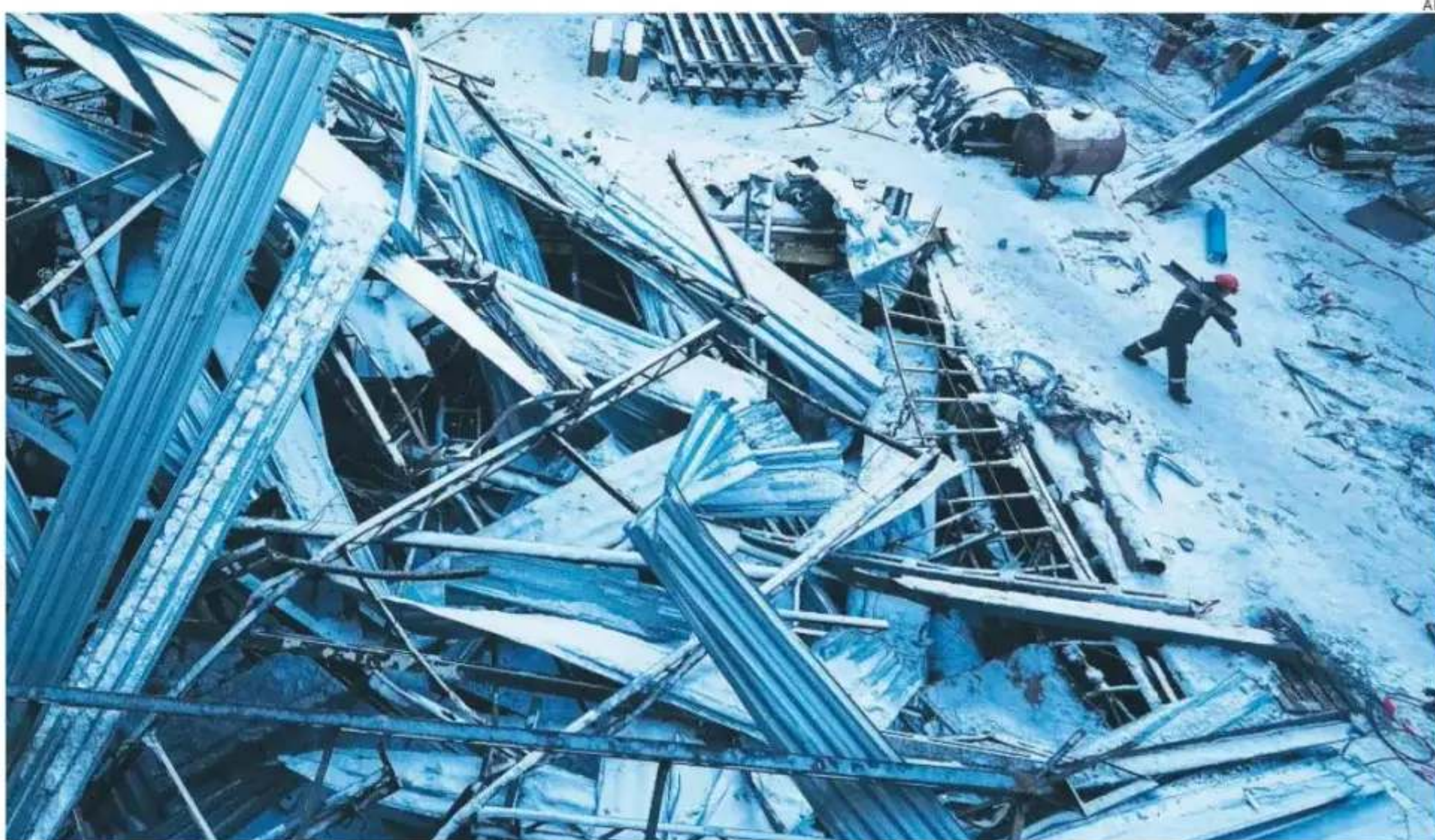
Trabajadores reparan las instalaciones de la compañía ucraniana DTEK tras un ataque ruso
